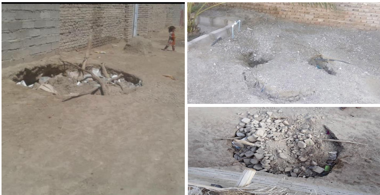
شکل ۱- فرونشست سطح زمین در بالای چاه‌های جذبی در منطقه مورد مطالعه
