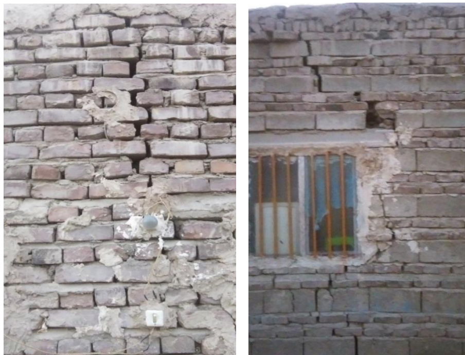
شکل ۲- ترک خوردگی و شکاف در دیواره‌های ساختمان‌ها در اثر فرونشست، در مناطق مسکونی دشت تهلاب
